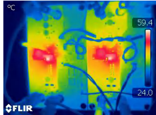
图 4-12. 升压区域中的热条件 ( V_{IN}=12V 且负载电流为 8A)
