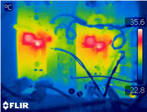
图 4-11. 升压区域中的热条件 ( V_{IN}=12V 且负载电流为 2A)
